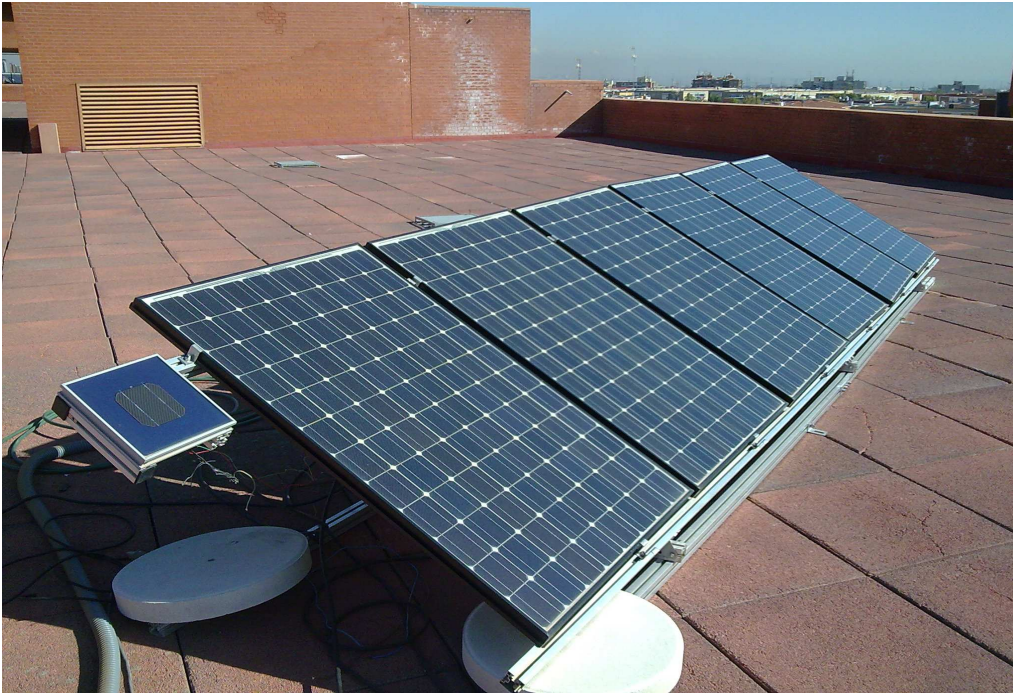
Figura 66 Fotografía de los 6 módulos fotovoltaicos Sanyo
