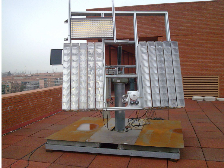
Figura 4 Fotografía del seguidor solar instalado en la Universidad, en el que hay instalados módulos de concentración
