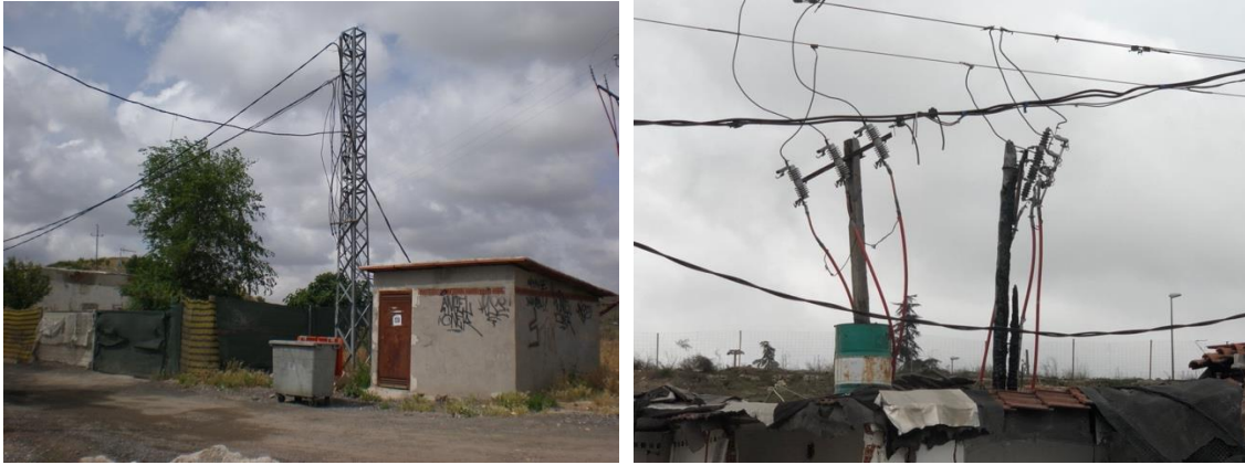
Figura 1. Conexiones eléctricas informales en la Cañada Real
