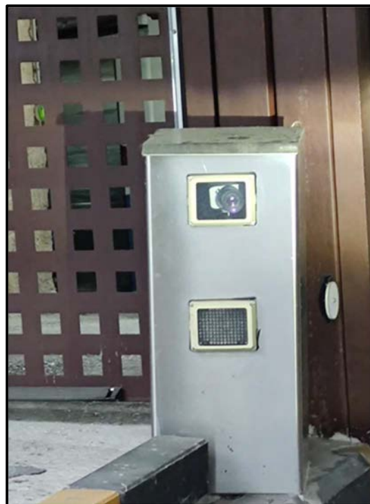
Figura 31: ejemplo de una cámara destinada al control de matrículas
