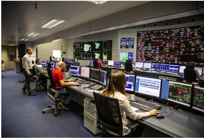
Figura 4.23: Centro de Control Eléctrico (CECOEL) de Red Eléctrica de España. Cortesía de Red Eléctrica de España.
