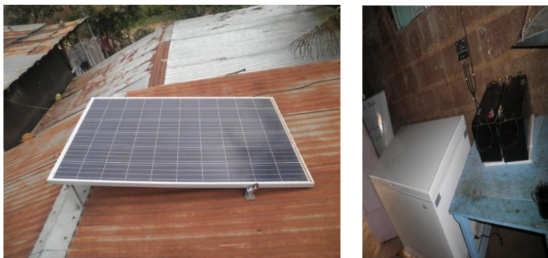
Figura 41: Situación del panel solar de 250Wp
