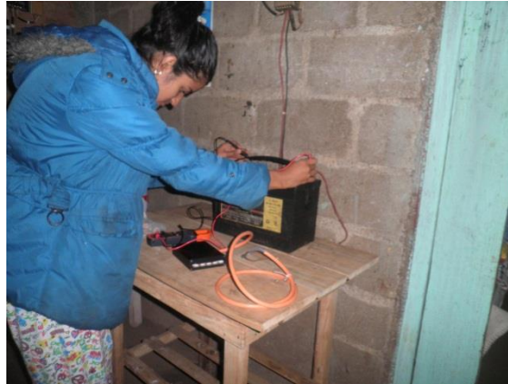
Figura 51: Multicargador conectado a la batería directamente
