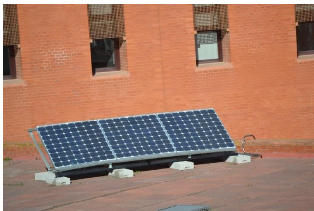
Figura 61: Generador FV de 450Wp situado en la azotea del edificio 1, sobre el laboratorio [imagen tomada desde la UC3M]
