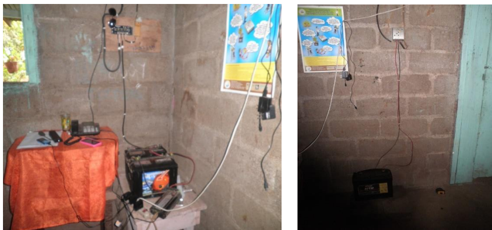
Figura 43: Sistema de acumulación del panel de 175Wp (izq.) y del panel de 75Wp (dcha.)
