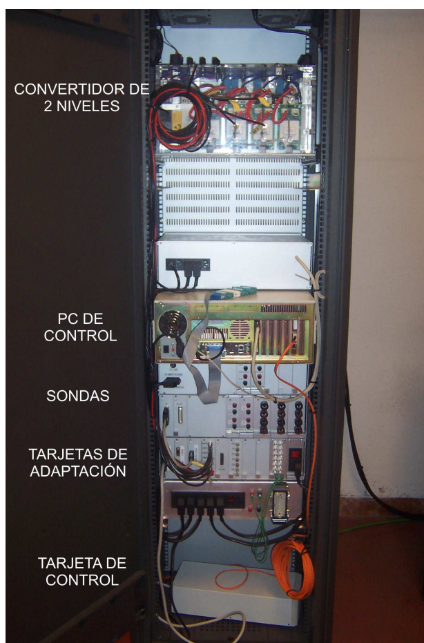
Figura A.2: Parte trasera del armario de control.
