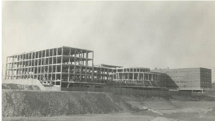
La Facultad de Filosofía y Letras durante su construcción (Archivo General de la Universidad Complutense de Madrid).
