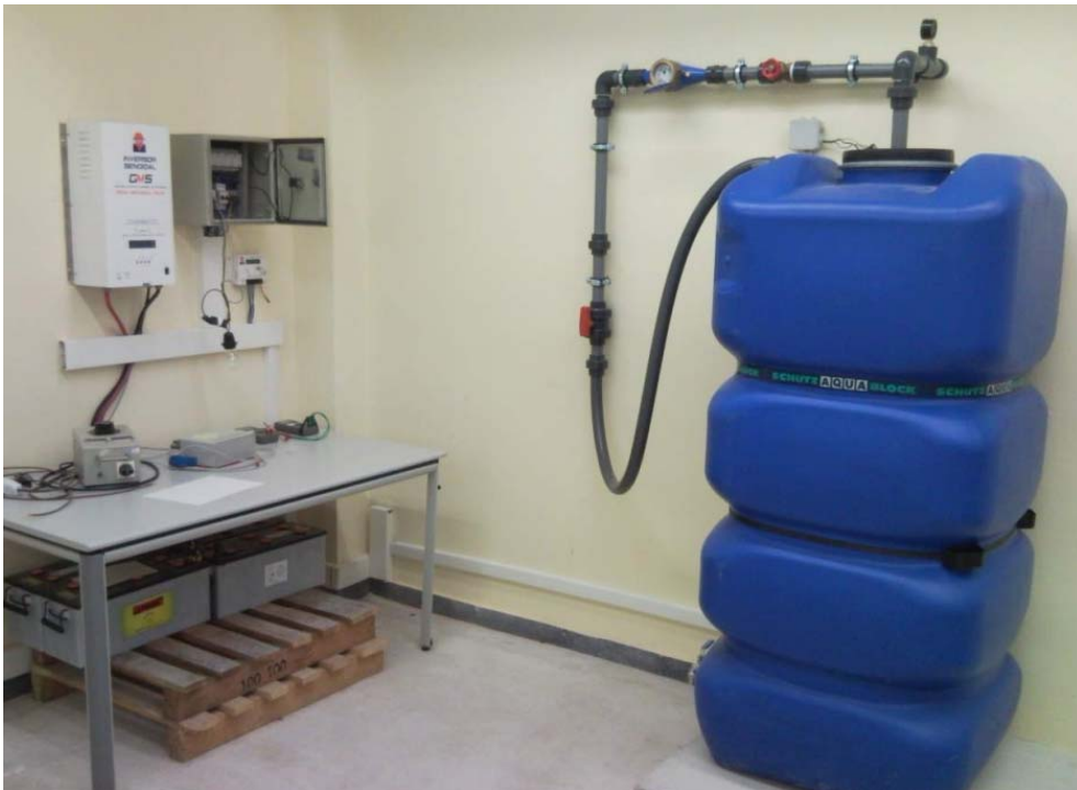
Figura 4.10 Sistemas hidráulico y FV
