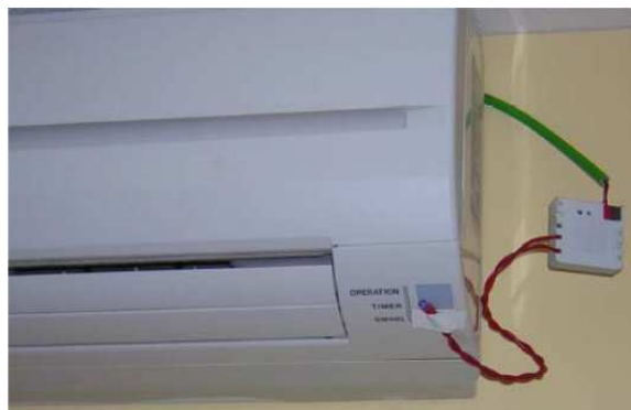
Figura 3.20 Detalle del controlador Zennio.
