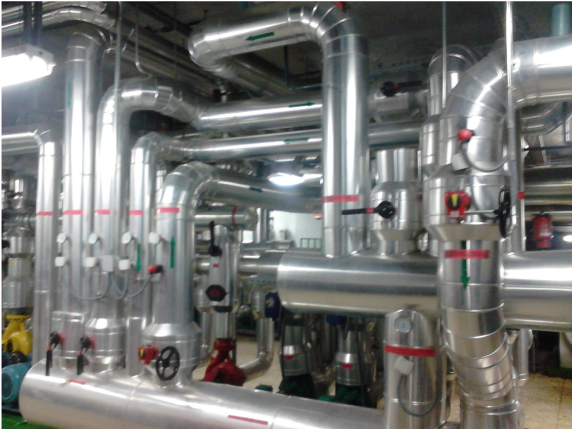
Figura 4: Colector corrido del circuito de agua caliente 117
