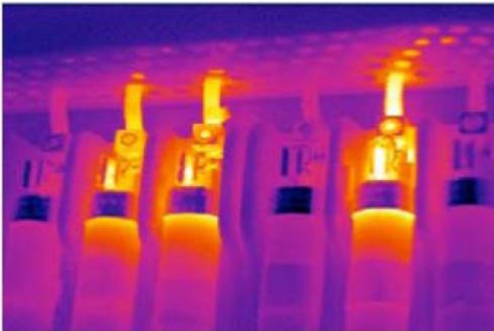
Figura 4. Imagen obtenida por termografía de un cuadro de mando
