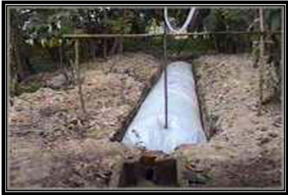
Fig. 9: Biodigestor de polietileno
